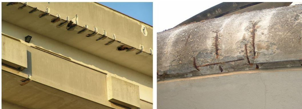
Figura 25 - Carbonatazione del calcestruzzo: espulsione del copriferro
