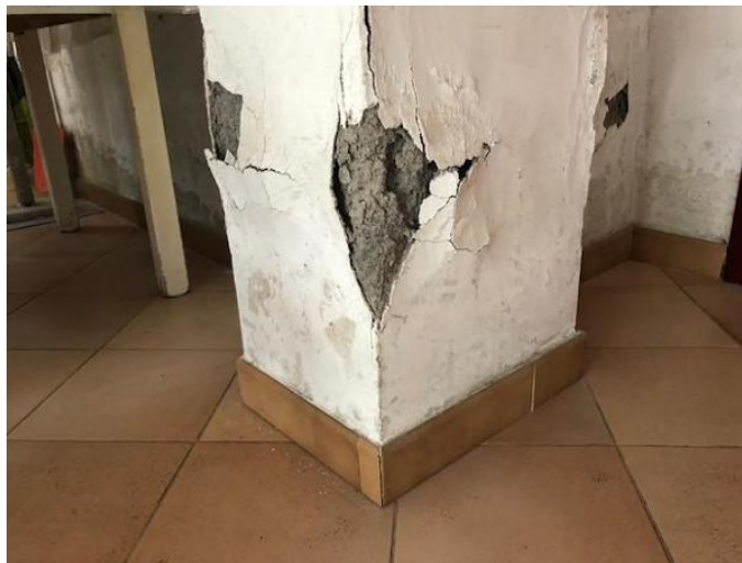
Figura 19- Distacco dell'intonaco da un pilastro in calcestruzzo armato
