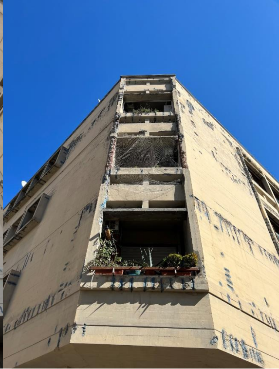
Figura 50 – Degrado sui balconi d'angolo (sud)
