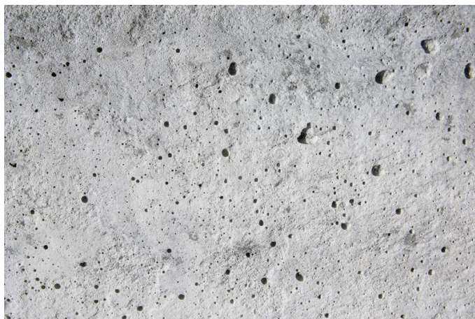
Figura 10- Alterazione del calcestruzzo dovuta all'uso di additivo superfluidificante
