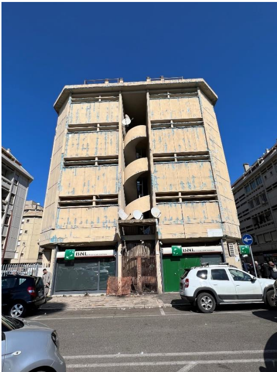
Figura 51 – Degrado sul prospetto sud (fronte mare)
