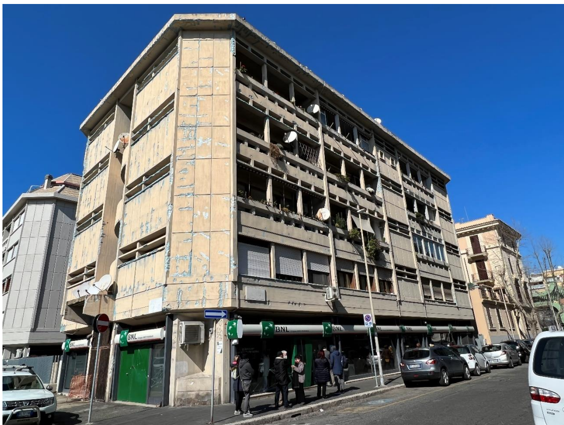
Figura 53 – Degrado sul prospetto est
