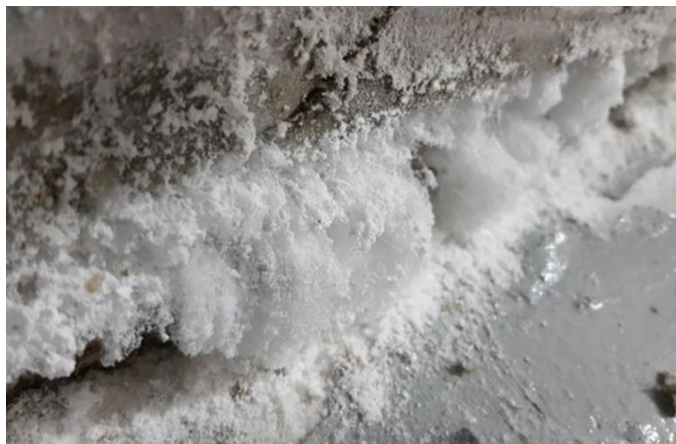
Figura 17 - Grave forma di efflorescenza dovuta a calcestruzzo di cattiva qualità
