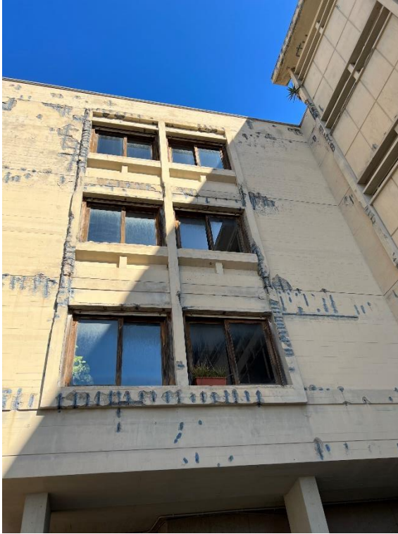
Figura 49 – Degrado sul prospetto interno (sud)
