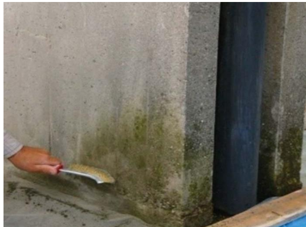
Figura 16 - Colonizzazioni biologiche su elementi in calcestruzzo armato
