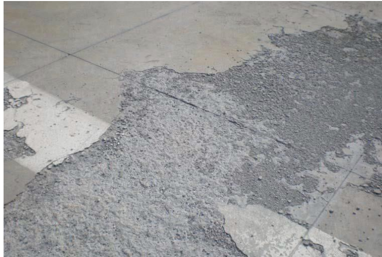
Figura 23 – Pavimentazione in cls usurata
