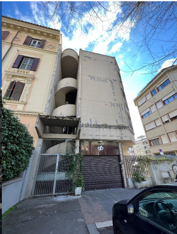
Figura 52 – Degrado sul prospetto nord
