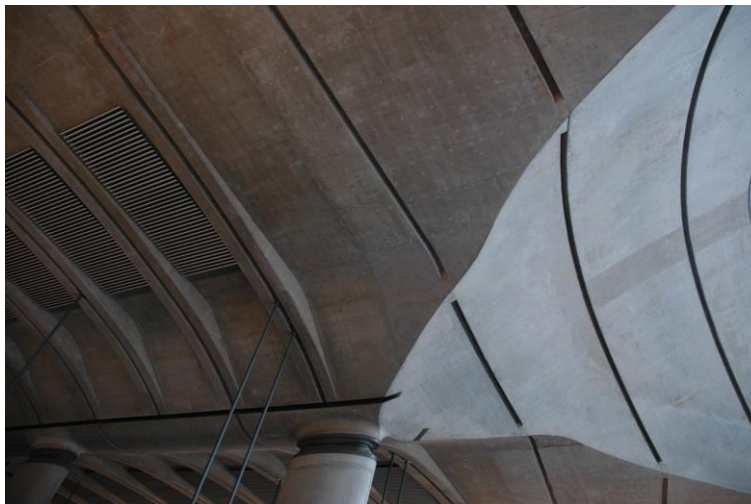
Figura 12 – Presenza di macchie sulla superficie in c.a.
