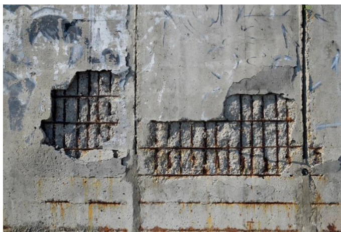
Figura 11 - Corrosione delle barre d'armatura dovuta all'uso di additivi antigelo
