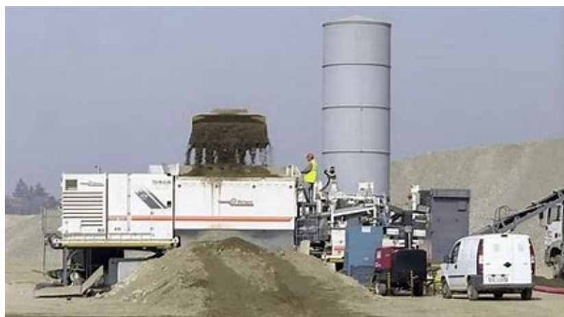
Fig. 1.2 impianto mobile per il riciclaggio a freddo
