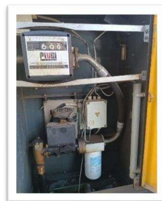
Fig.3.5 - CONTALITRI MECCANICO PRESENTE NELL'IMPIANTO
