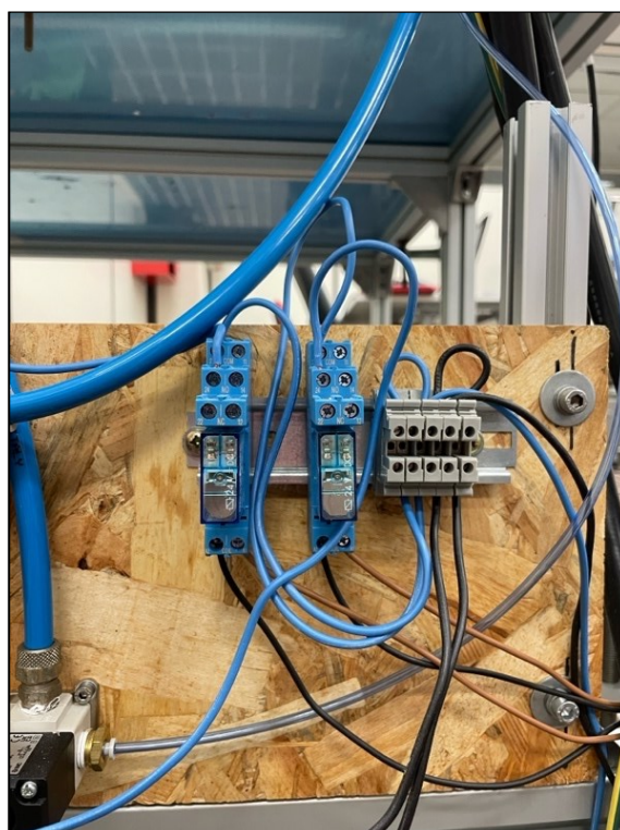
Figura 2.5. 17: Dettaglio dei relè per il controllo delle elettrovalvole.
