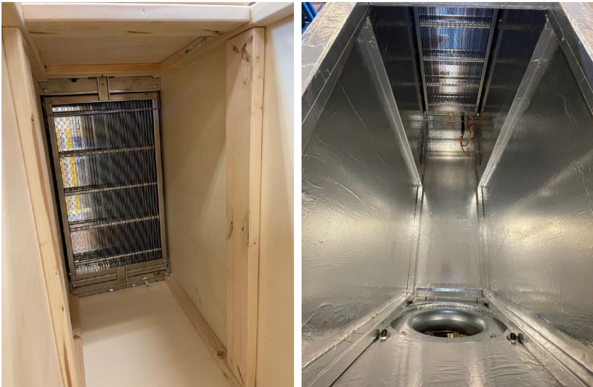
Fig 32. A sinistra vista frontale del filtro all'interno del box prima del rivestimento, a destra vista dall'alto del box dopo il rivestimento
