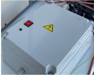
Fig 23. Collegamento elettrico dell'elettrofiltro
