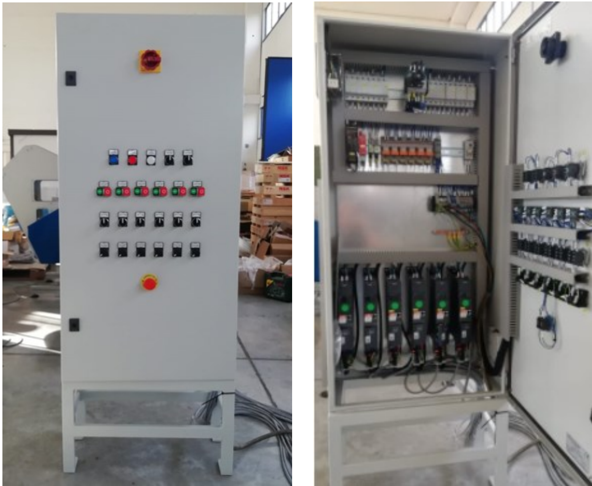
Fig. 7.21 Quadro elettrico blocco 1
