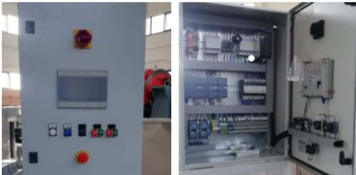
Fig. 7.82 Quadro elettrico sottoblocco 1 blocco 2
