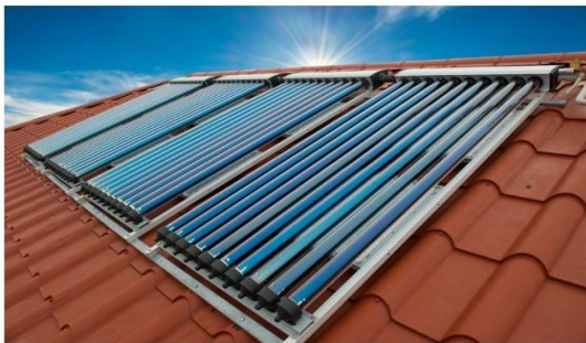
Figura 5- Esempio di un impianto solare termico installato su un tetto di una casa [4].
