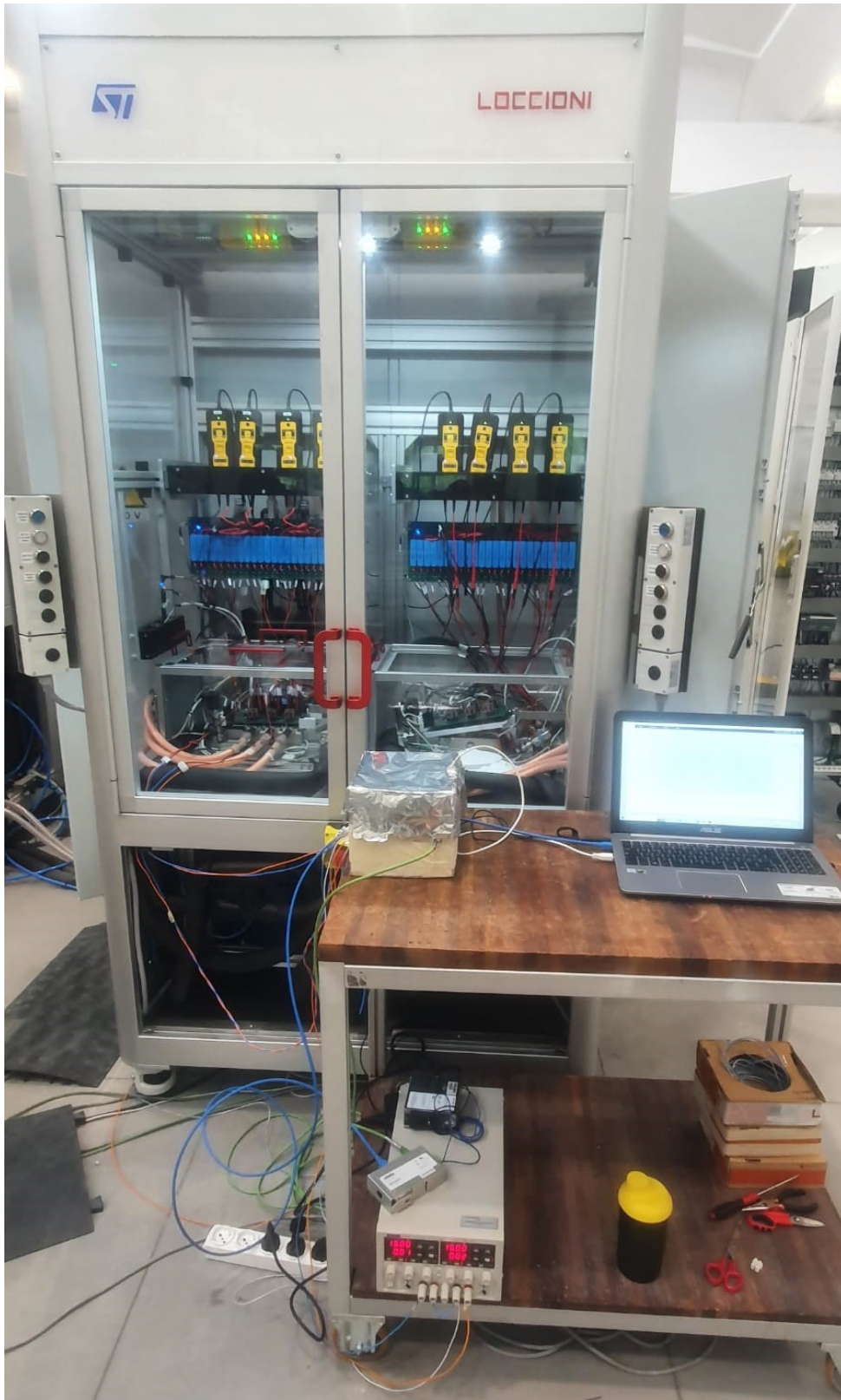
Figura 8-20: set-up schermatura sistema di acquisizione
