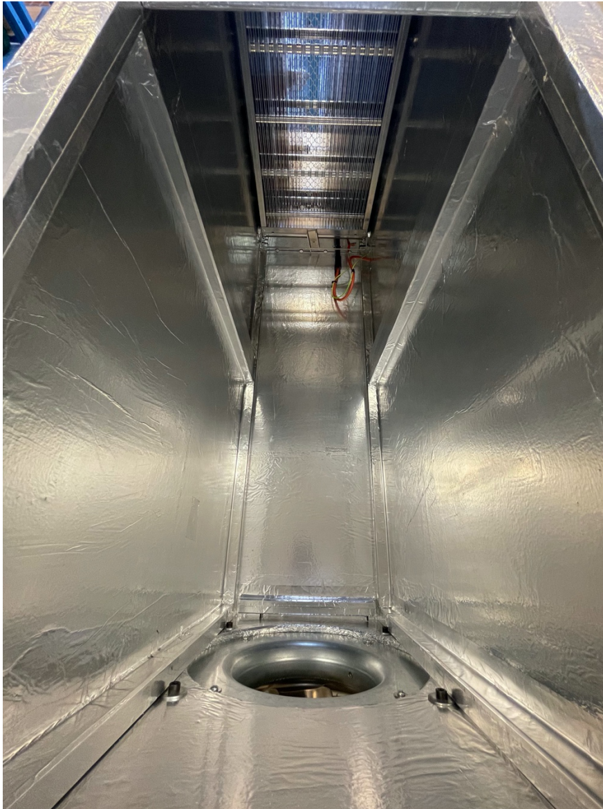
Figura 22– Interno della canalizzazione vista dall'alto
