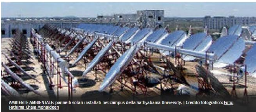
Figura 55: Pannelli solari installati nel campus della Sathyabama University
