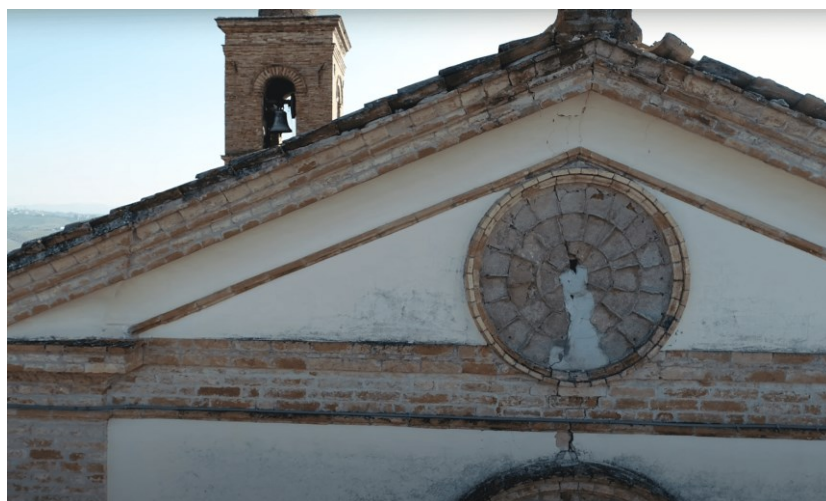
Figura 3.18 – Lesione verticale della facciata, che denota un tentativo di apertura della navata nella direzione est/ovest
