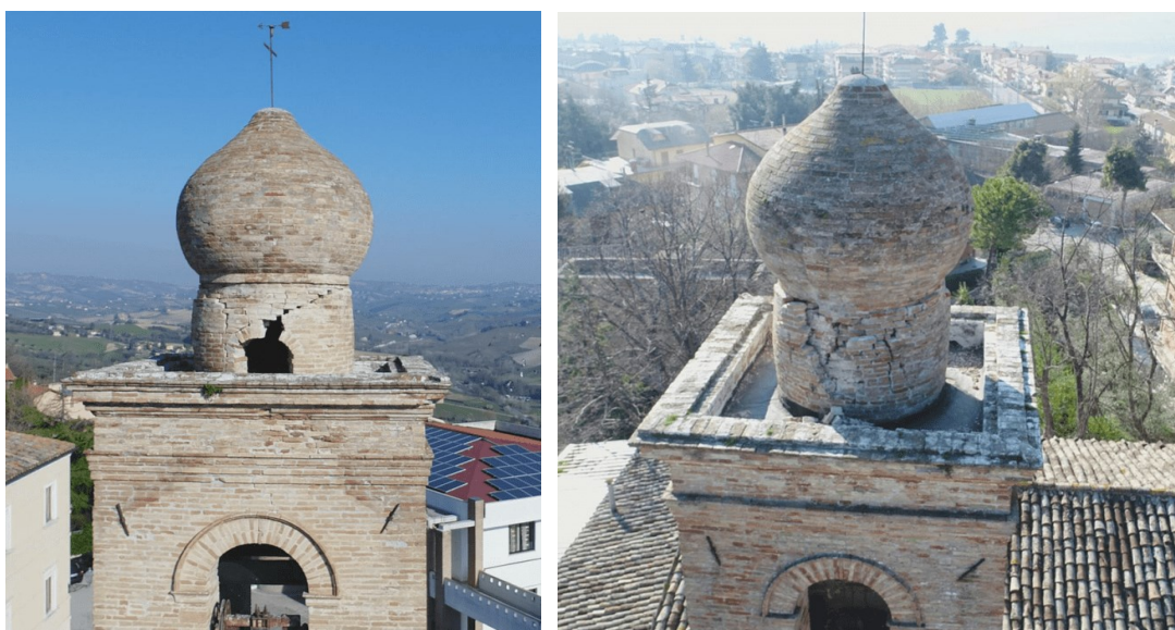
Figura 3.16 – Fessure torrino campanile. Sul lato est (foto a sinistra) l’arco risulta compromesso, con caduta del concio di chiave e dislocamento del paramento adiacente verso l’esterno con riduzione notevole delle superfici di appoggio dei mattoni fra le varie file. Mentre, sul lato ovest (foto a destra) si nota un’espulsione di gran parte del paramento esterno e dislocamento evidente anche del paramento interno con diffuse ed importanti lesioni
