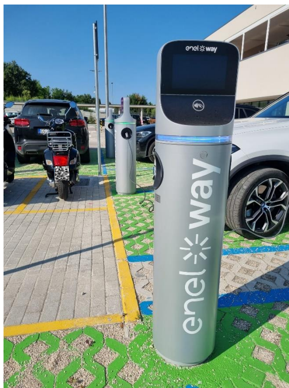
Figure 3 - Colonnine elettriche in sede a Spoltore
