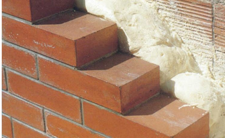
Figura 7 esempio poliuretano espanso a spruzzo
