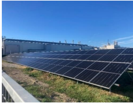
Figura 3.5: Nuovo impianto fotovoltaico (sede Recanati)
