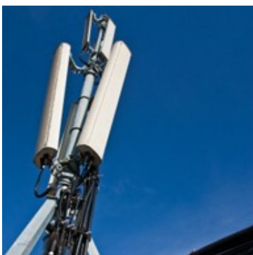
Fig. 3 – Antenna per telefonia cellulare.
