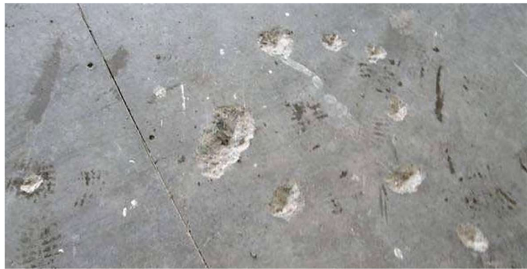
Fig. V – Fenomeno di pop-out di conetti di calcestruzzo a ridosso di aggregati reattivi
