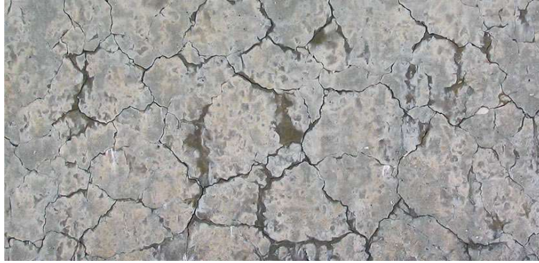
Fig. IV - Map Cracking generata dalla reazione alcali-silice
