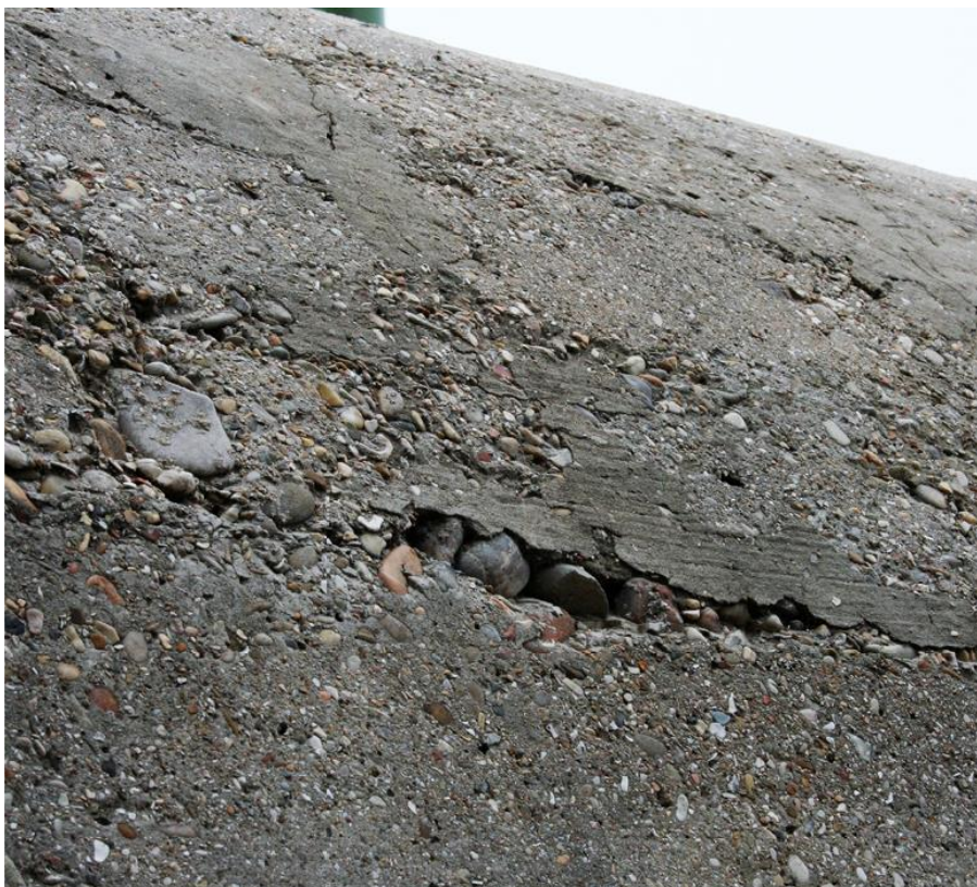
Figura 33 _dettaglio esterno bunker, si possono notare i nidi di ghiaia
