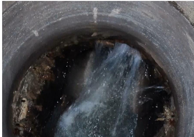
Figura 87 Infiltrazione in un pozzetto. Fonte Ecogrundingspecialist.
