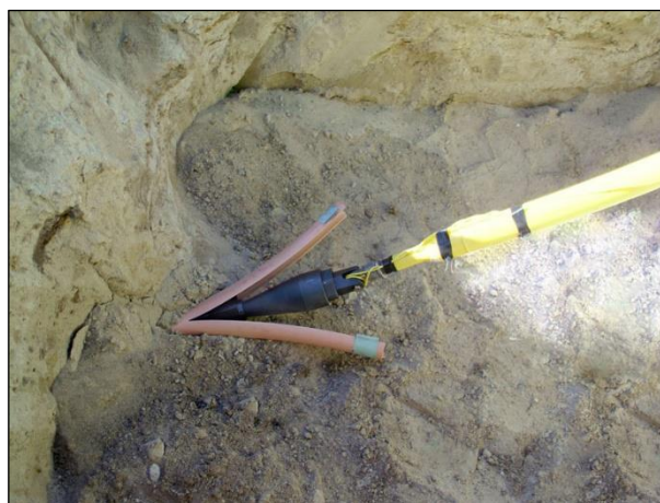
Figura 113 Sezionamento in lembi della condotta esistente determinato dalla testa tagliente. Fonte: https://www.ukstt.org.uk/pf/pipe-splitting/ .
