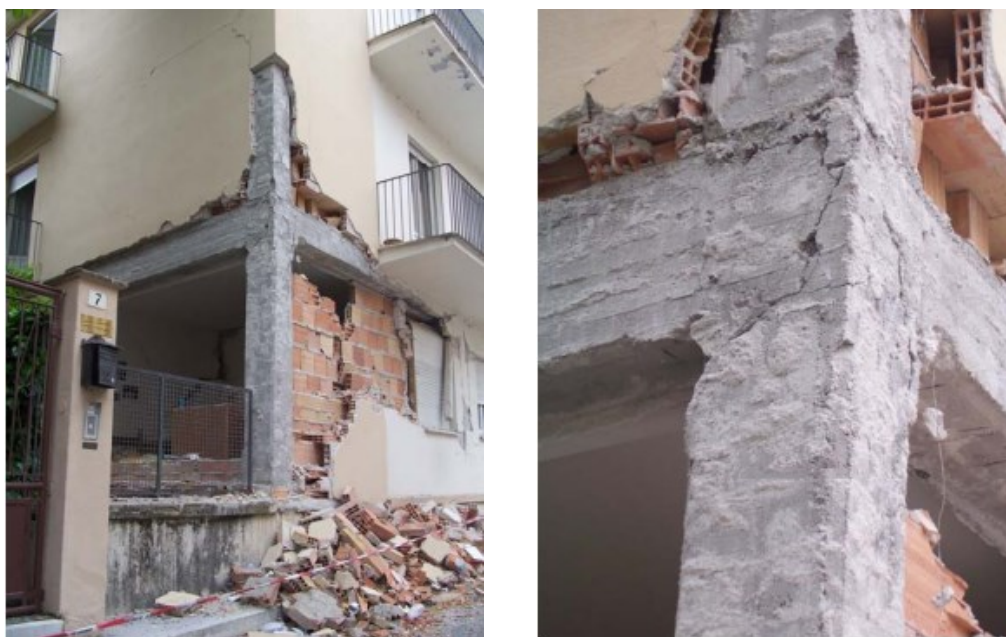
Figura 26 - Nodo danneggiato dal sisma: a) vista d’insieme b) particolare del nodo trave-pilastro
