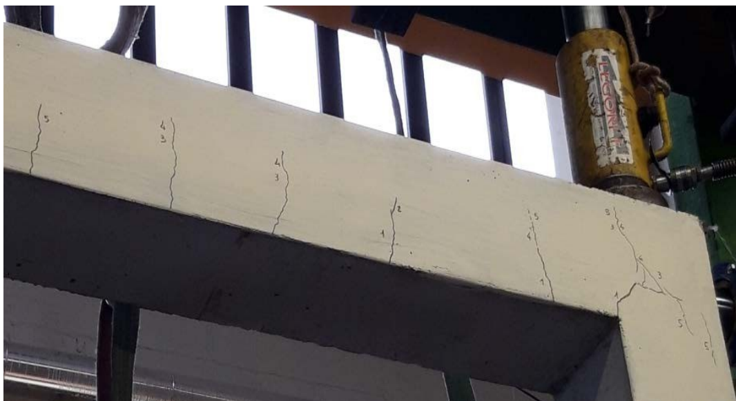
Figura 65 b) - Fessurazione del nodo in c.a
