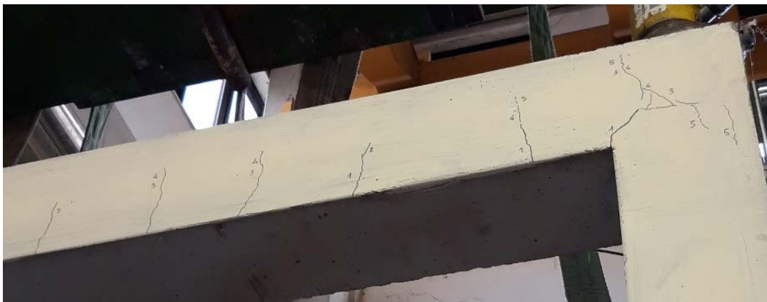
Figura 65 a) - Fessurazione del nodo in c.a
