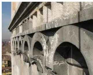
Fig. 1 Effetti del deterioramento dell’intonaco
