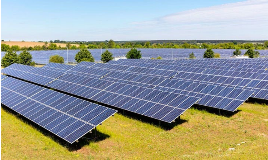
Figura 5-1: Impianto fotovoltaico a terra
