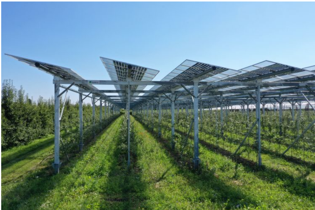
Figura 4-1: Impianto agrivoltaico elevato
