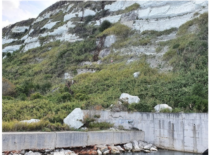
Figura 7 - Zona franosa al di sopra dell'opera di fognatura
