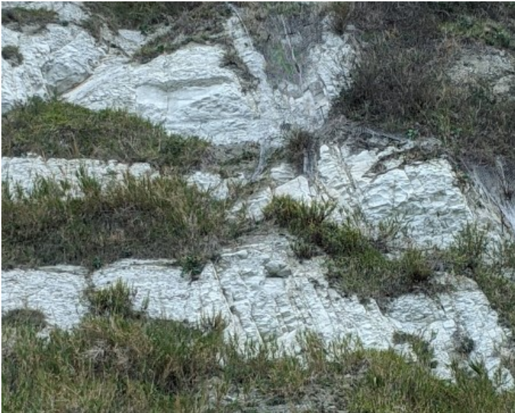
Figura 9 - Famiglia di fratture sulla falesia al di sopra del canale
