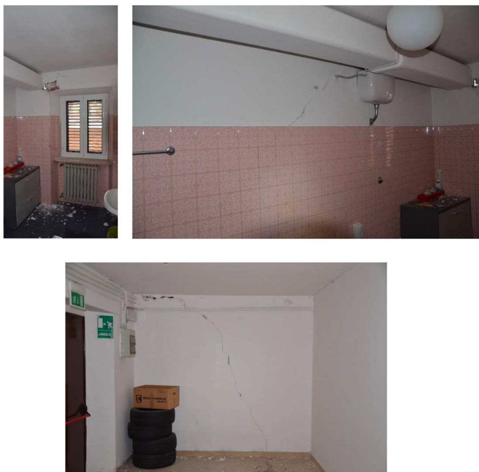
Figura 4.30: Danni sismici rilevati al piano seminterrato.
