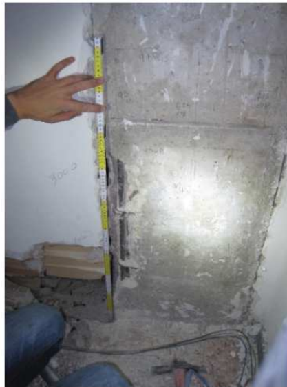
Figura 4.7: Particolare della lunghezza di sovrapposizione delle barre longitudinali dei pilastri.
