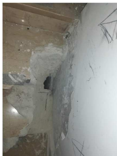
Figura 4.16: Particolare dell'assenza di collegamento tra scala e nucleo ascensore.
