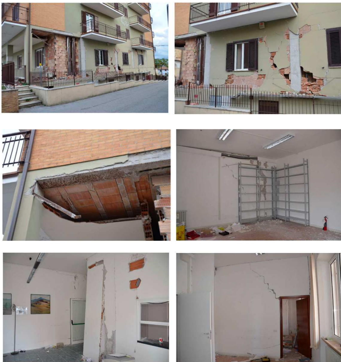
Figura 4.31: Danni sismici rilevati al piano terra.
