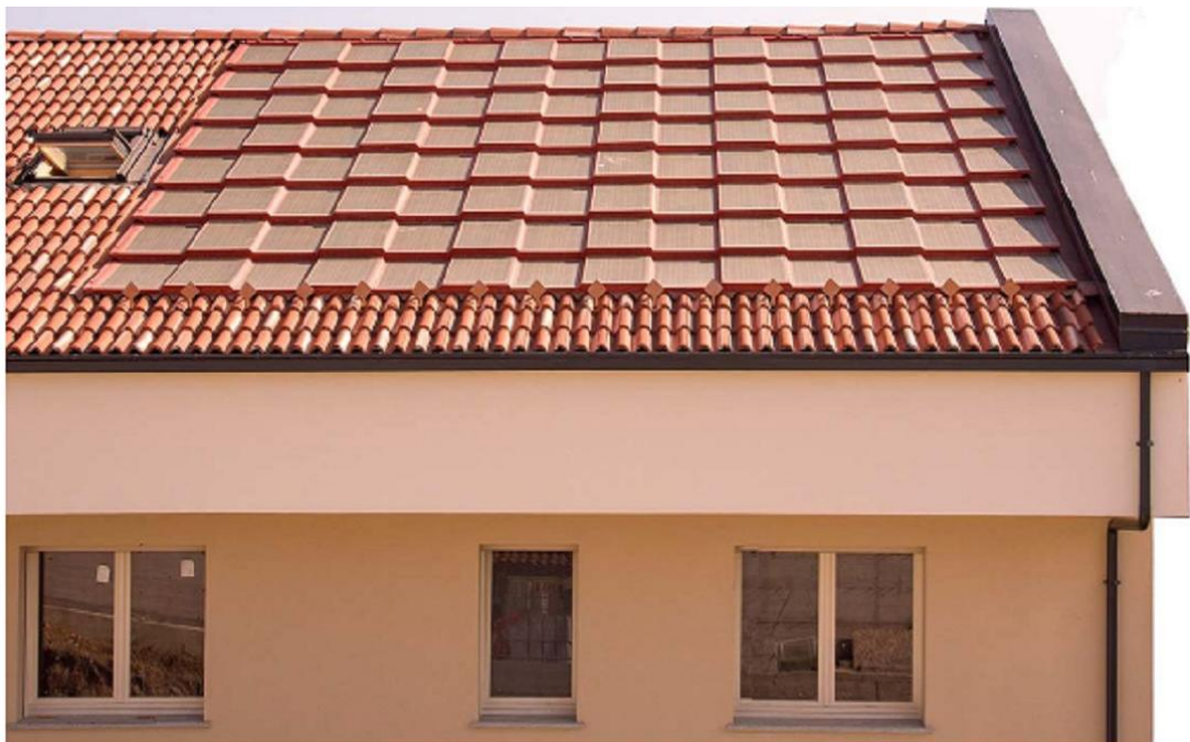
Figura 3.4.1: Esempio di Fotovoltaico integrato
