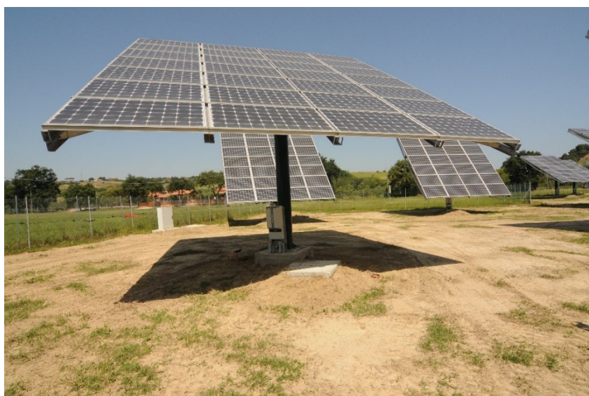
Fig. 2.6 – Impianto Fotovoltaico di Porto Recanati
