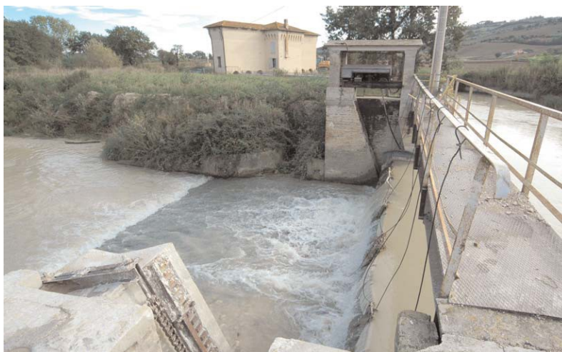
Fig. 2.3 - Opera di presa sul fiume Potenza
