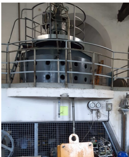
Fig. 2.5 - Turbina KAPLAN risalente all'anno 1952 installata su fiume Potenza - derivazione acqua fluente
