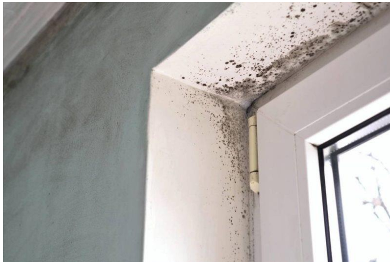
Figura 6-Muffe dovute ai ponti termici
