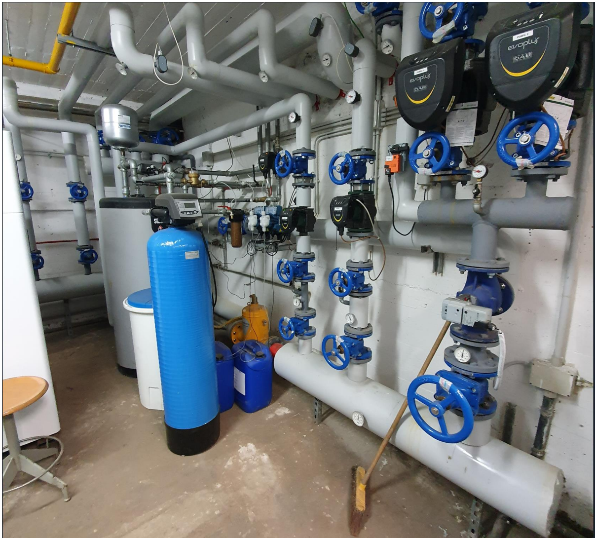
Figura 45-Pompe di circolazione in centrale termica
