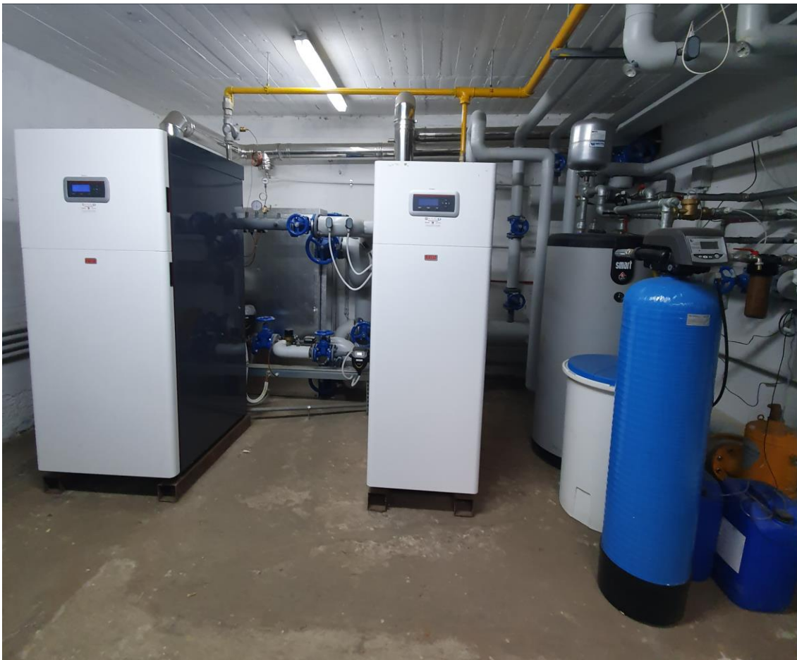
Figura 44-Generatori di calore in centrale termica
