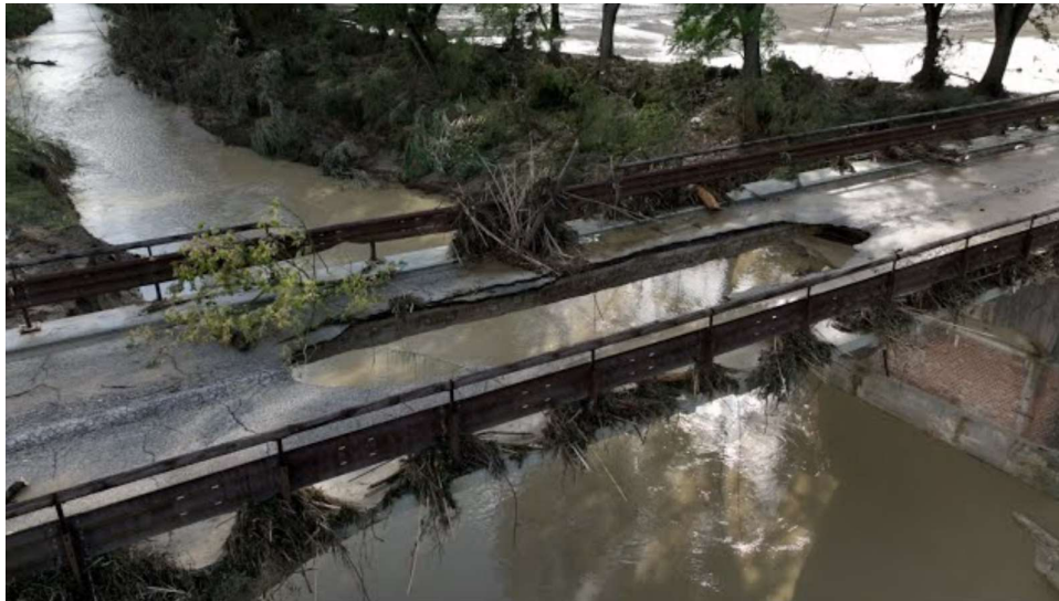
Figura 2: Crollo ponte sul fiume Misa con distacco della pila centrale.
