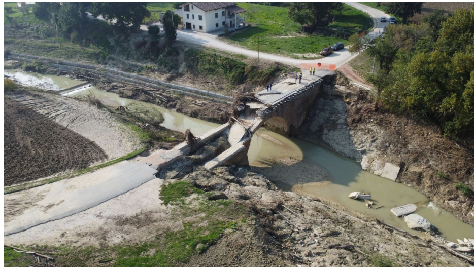
Figura 1: Crollo ponte sul fiume Nevola a seguito dell'alluvione del 15 settembre 2022.
