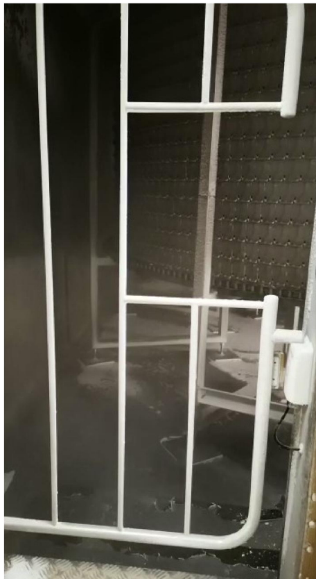
Figura 22: dettaglio surgelatore a spirale
