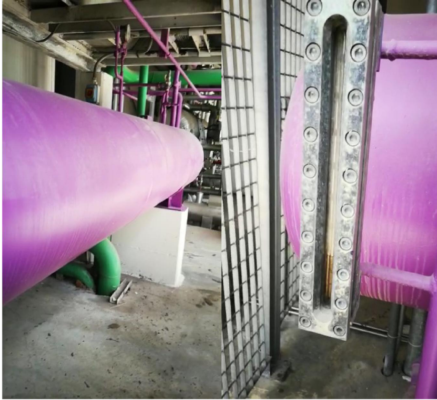
Figura 26: serbatoio ammoniaca Figura 27: indicatore di livello ammoniaca
