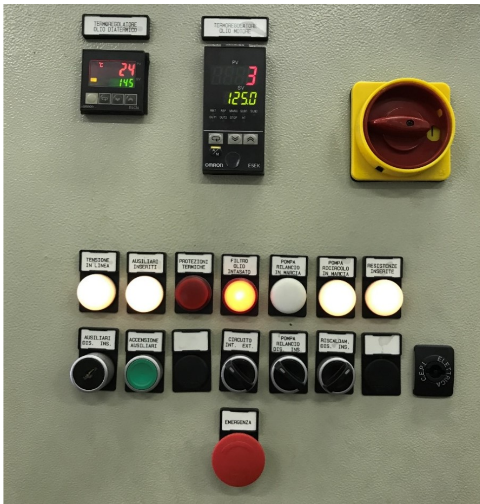
Figura 46: quadro comandi CT
