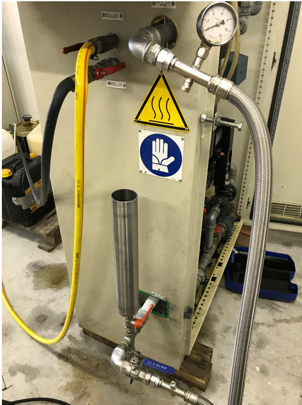
Figura 35: sistema di ingresso e uscita olio dal CT, con valvole e imbuto di rabbocco olio
