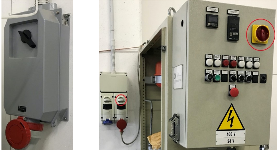
Figura 45: interruttori rotativi di alimentazione inverter e CT
