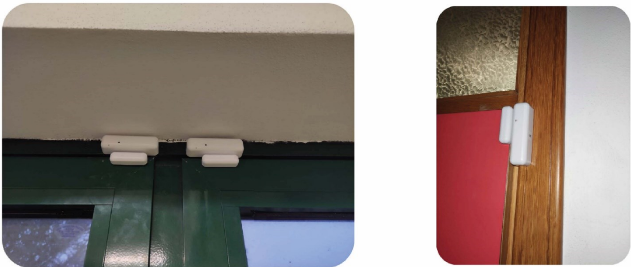
Figura 25_Sensori di presenza installati a Falconara
