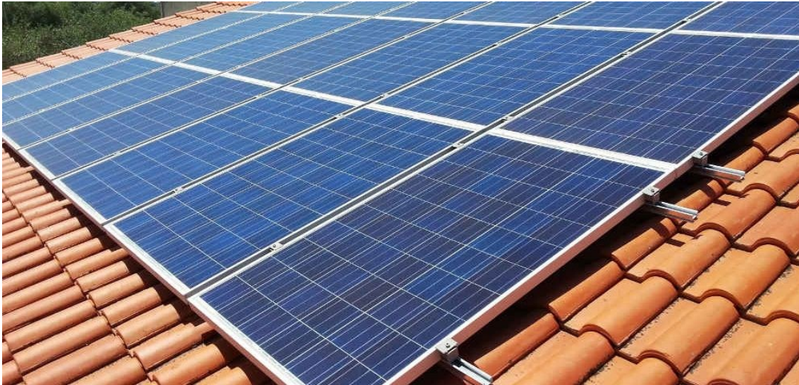
Figura 30: Esempio di pannelli fotovoltaici installati sul tetto di un edificio
