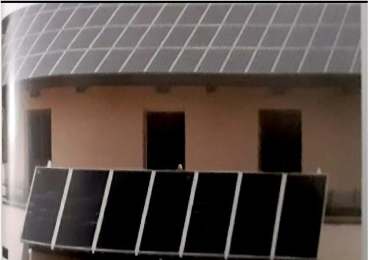
Figura 19 – Pannelli solari termici e fotovoltaici
