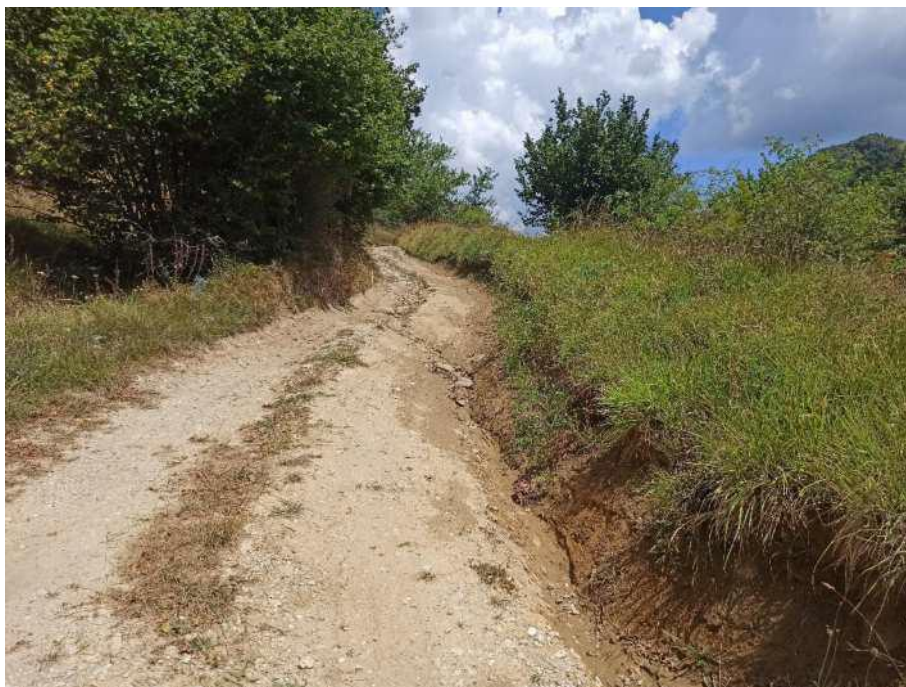
Figura 18. Carreggiata deteriorata da un solco provocato dallo scorrere delle acque meteoriche.
