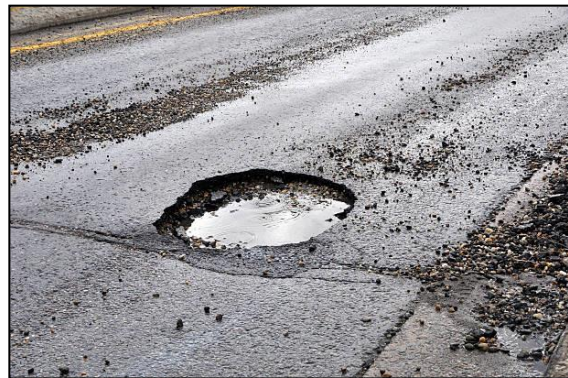
Figura 27: Manto stradale con buca
