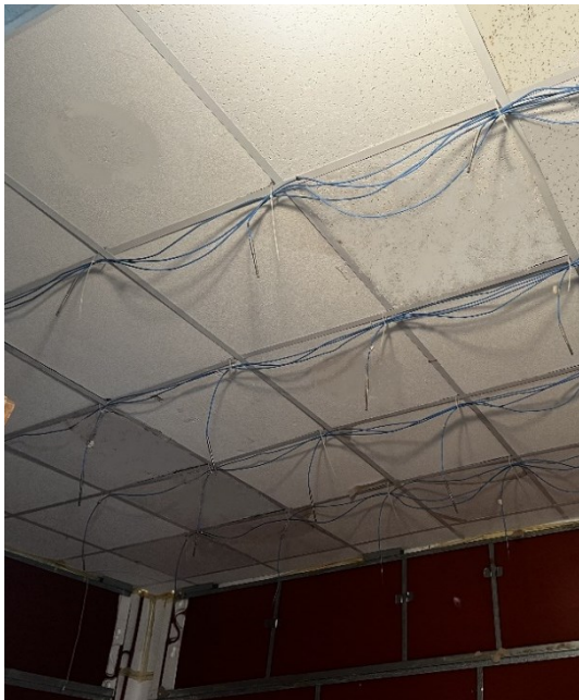
Figura 24: Controsoffitto con Pannelli classici
