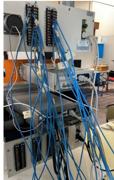
Figura 13: Cablaggio termocoppie con punto di zero K170
