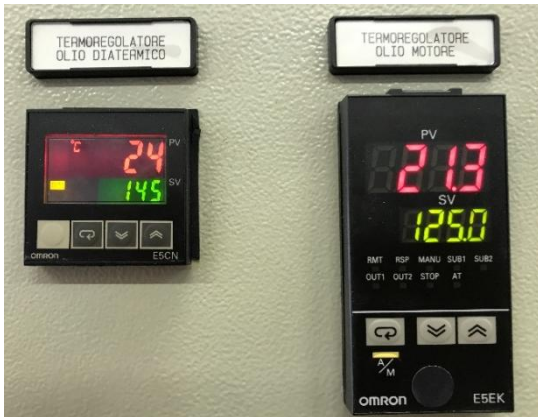
Figura 8. Quadro comandi e PID di controllo temperatura
