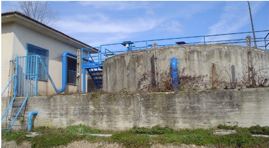
Figura 10: Impianto di depurazione del comune di Volturara Irpina
