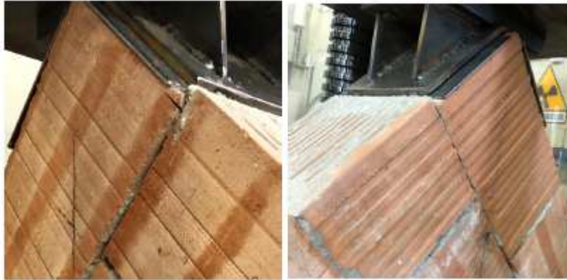
Figura 4.17 – Particolare dello scorrimento lungo il giunto di malta lato 1 e lato 2.
