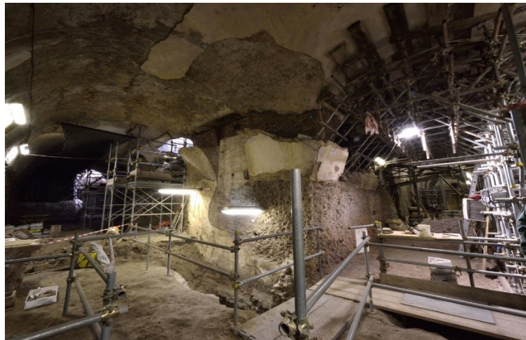
Figura 29. Situazione di dissesto nell'angolo nord-ovest del criptoportico
