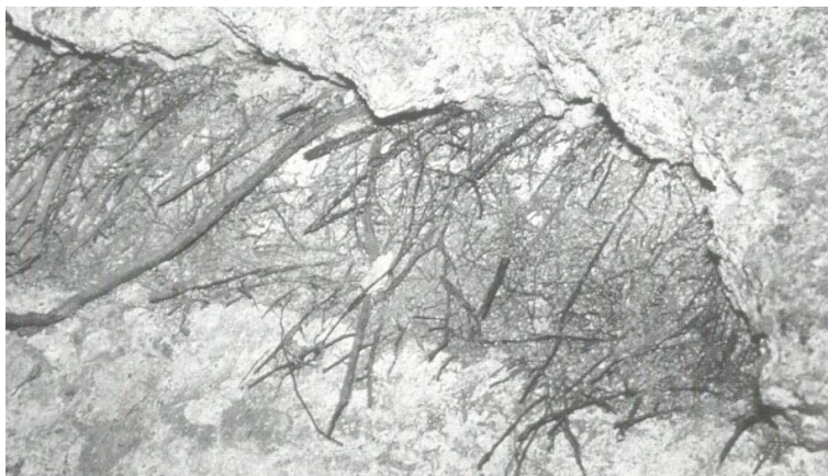
Figura 31. Danni operati da radici di leccio su malte e murature
