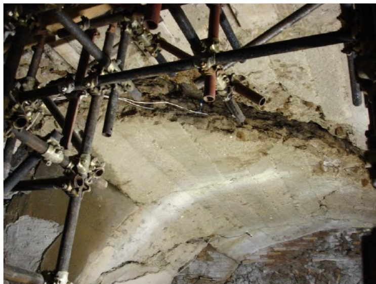
Figura 28. Scollamento della contro volta
