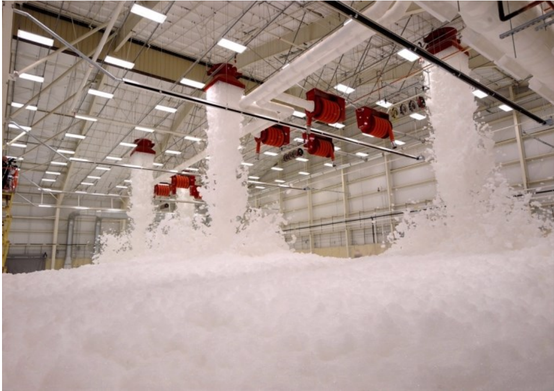
Figura 3.41 – Impianto a schiuma in funzione
