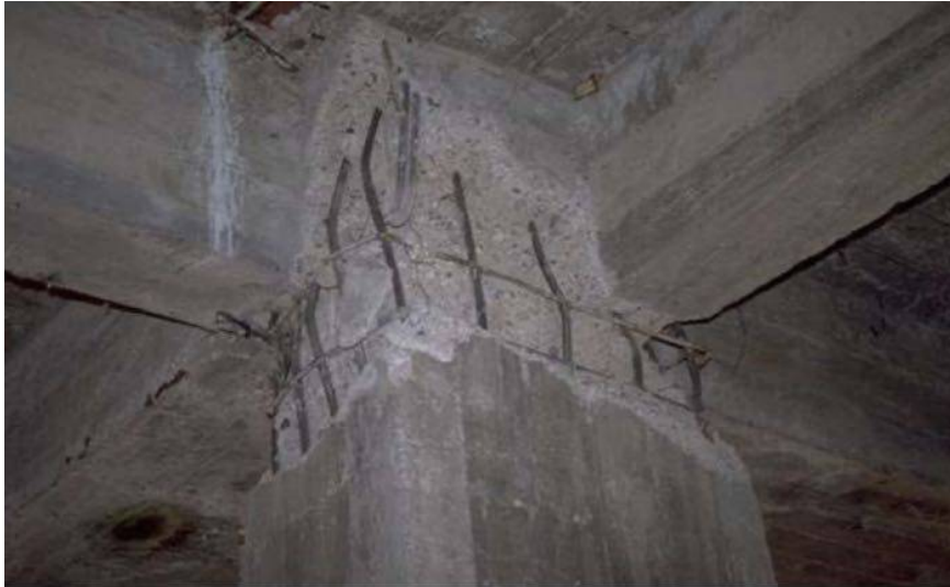
Figura 1.16 – Fenomeno instabilità dell'armatura longitudinale del pilastro
