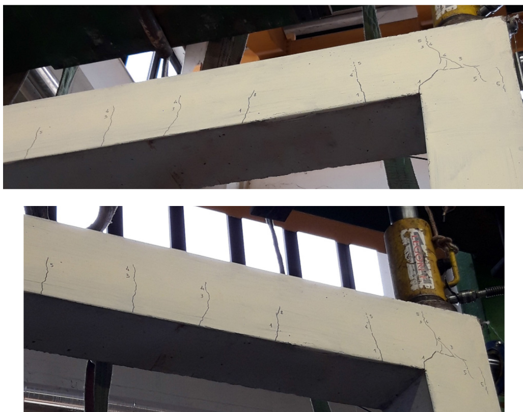
Figura 3.15 – Fessurazioni in prossimità del nodo
