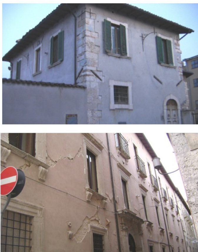
Figura 31 - MUR-2 – Edifici in muratura “antichi migliorati” – L'Aquila.
