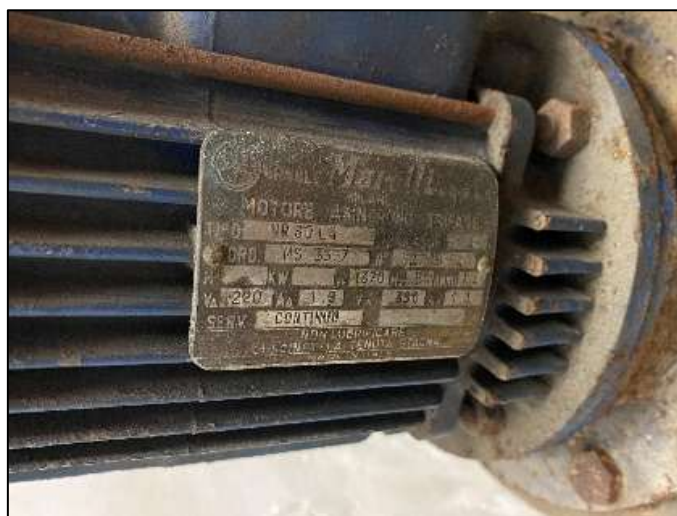
Figura 14: Pompa di circolazione
