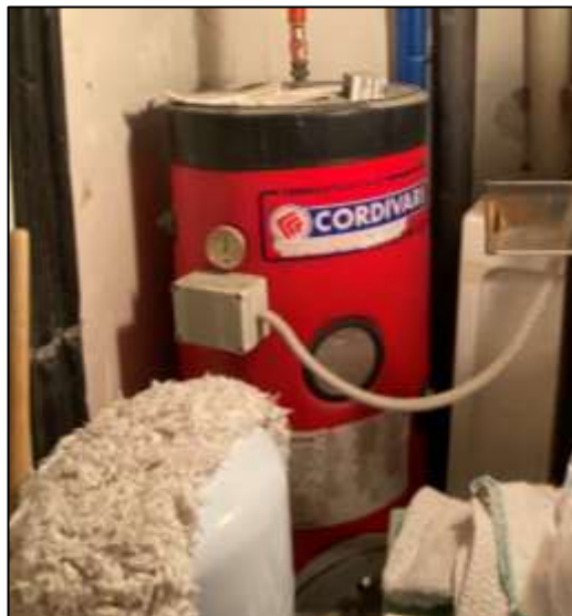
Figura 28: Boiler da 200l
