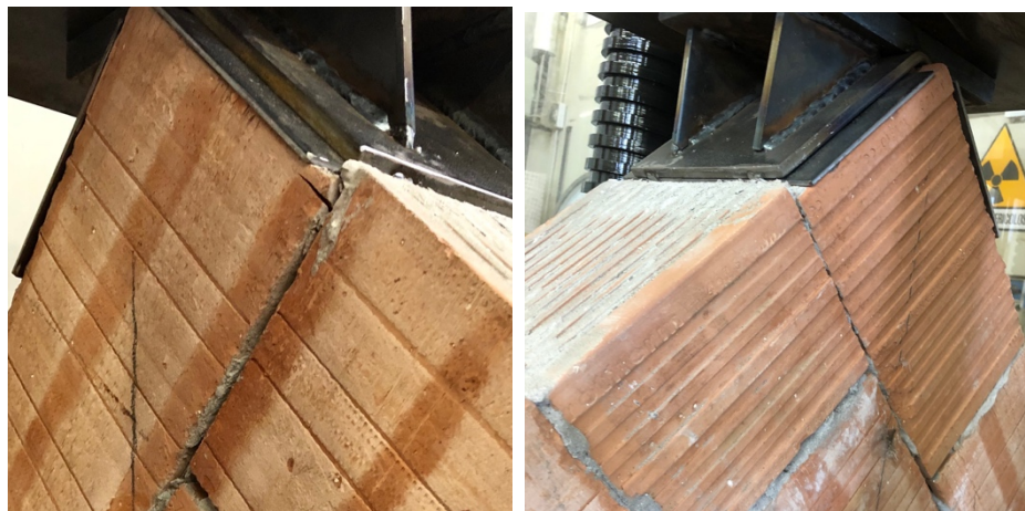
Figura 4.12 Particolare scorrimento lungo il giunto Lato 1 e lato 2
