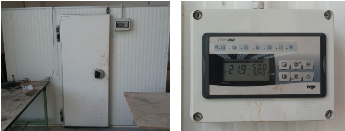
Figura 23 Camera climatizzata e pannello regolatore
