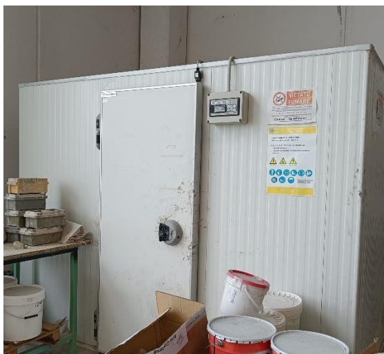
Figura 19 Camera climatizzata a temperatura e umidità controllata.
