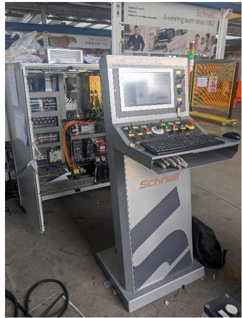
Figura n. 18: Quadro elettrico, consolle
