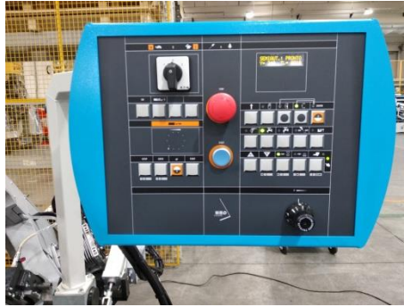
Quadro elettrico di una macchina
