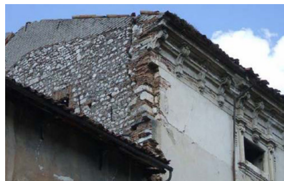
(b) Meccanismo locale di ribaltamento semplice della facciata, dovuto ad uno scarso ammorsamento di questa con pareti ortogonali e solai interpiano- Palazzo Ardinghelli (AQ)
