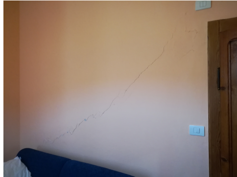
(b) Lesione a taglio su uno dei muretti interni
