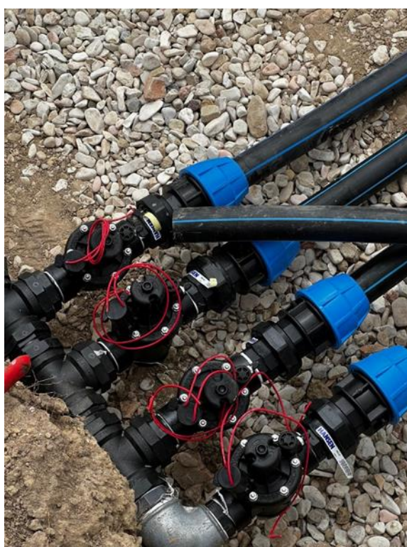
Figura 34. Terminali elettrici delle elettrovalvole
